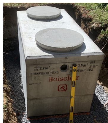
Fosse septique en béton.
